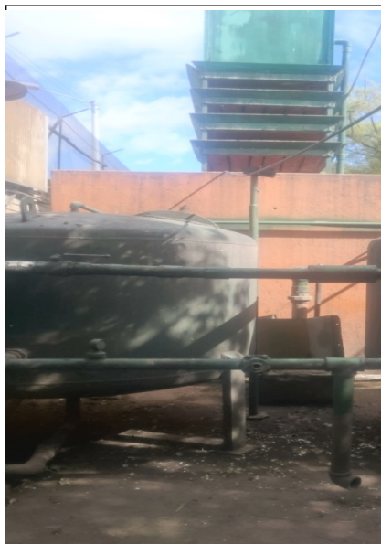
Foto 6. Planta de tratamiento en desuso
